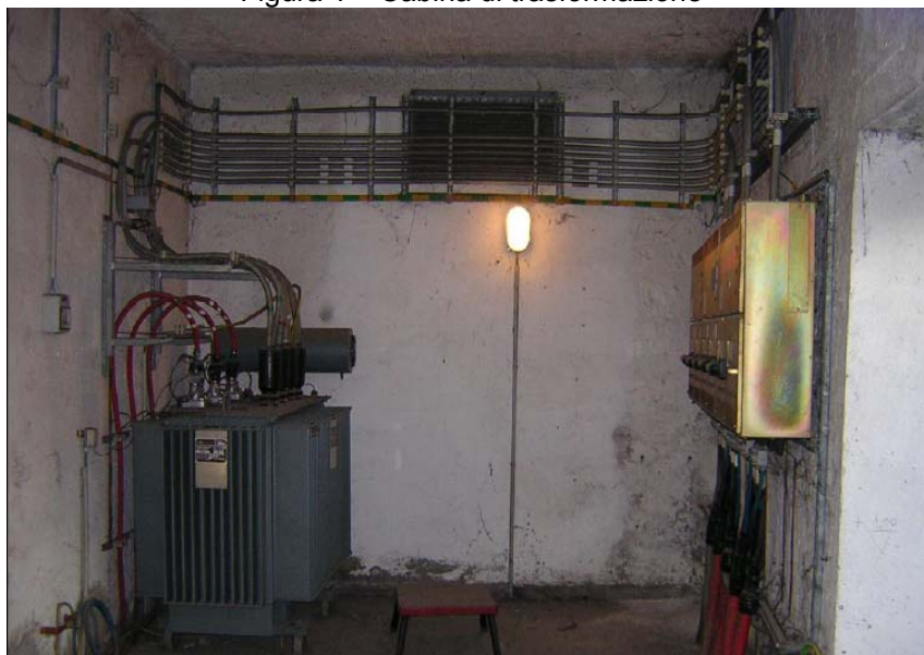
Figura 1 – Cabina di trasformazione
