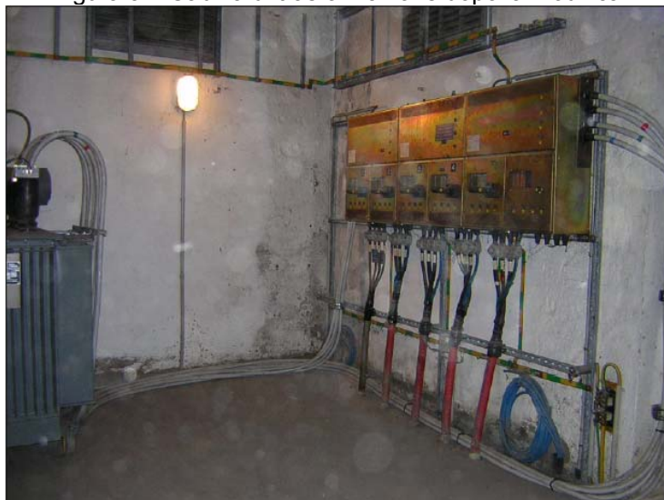
I cavi di bassa tensione passano ora sul pavimento del locale cabina
